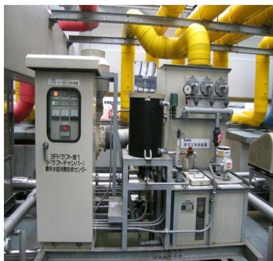
排ガス洗浄装置 (湿式スクラバー)
